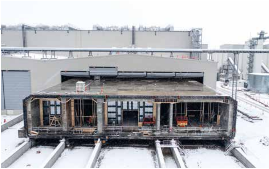
Tunnelfabrikken udgør en stor del af byggepladsen i Rødbyhavn. Her ses et af tunnelelementerne.
